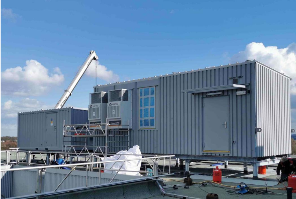
Containerlösung inkl. technischer Gebäudeausstattung für ein Rechenzentrum
